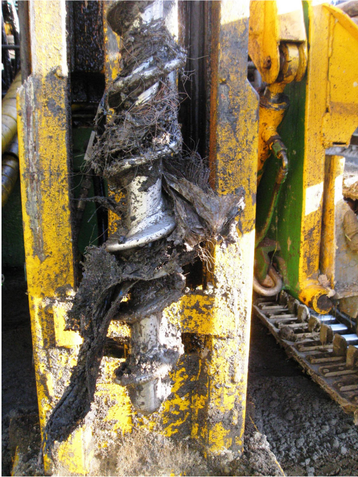
Figur 15 Område 3b – borhull 17, vaier og, plastikk som har festet seg på boret
